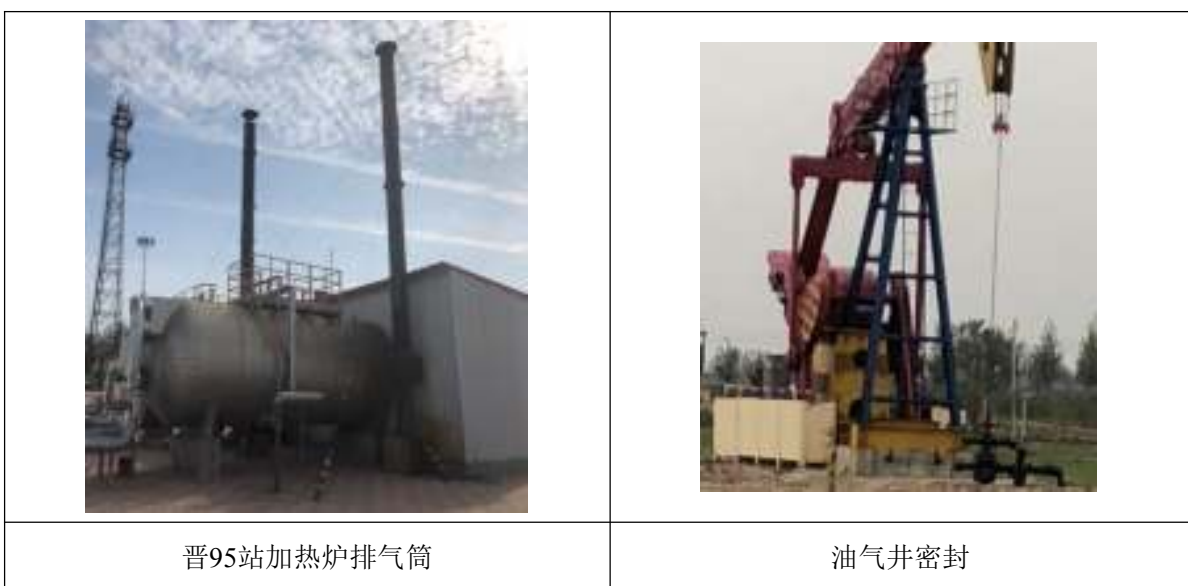
图5-3 废气环保治理设施
